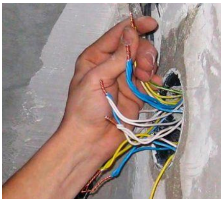
Рисунок 4 - Вид на ответвительную коробку встраиваемого типа для скрытой электропроводки.
