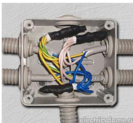
Рисунок 3 - Вид на ответвительную коробку накладного типа для открытой электропроводки.
