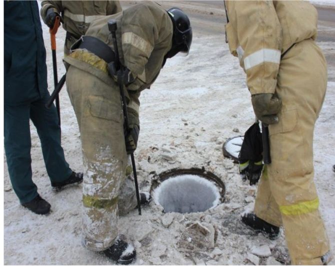
Рис. 1 Замерзший стояк пожарного гидранта
